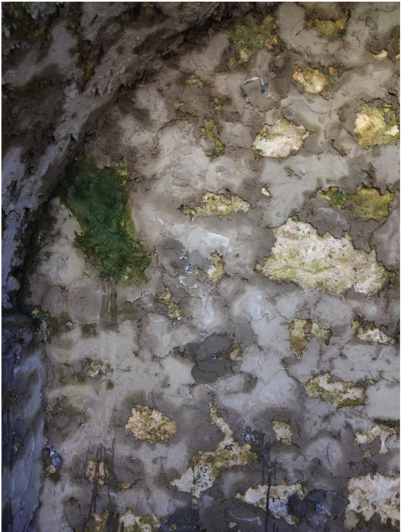
Παρά τις εργασίες αρμολογήματος και ενέματος, υγρασία διαπερνά την τοιχοποιία.
