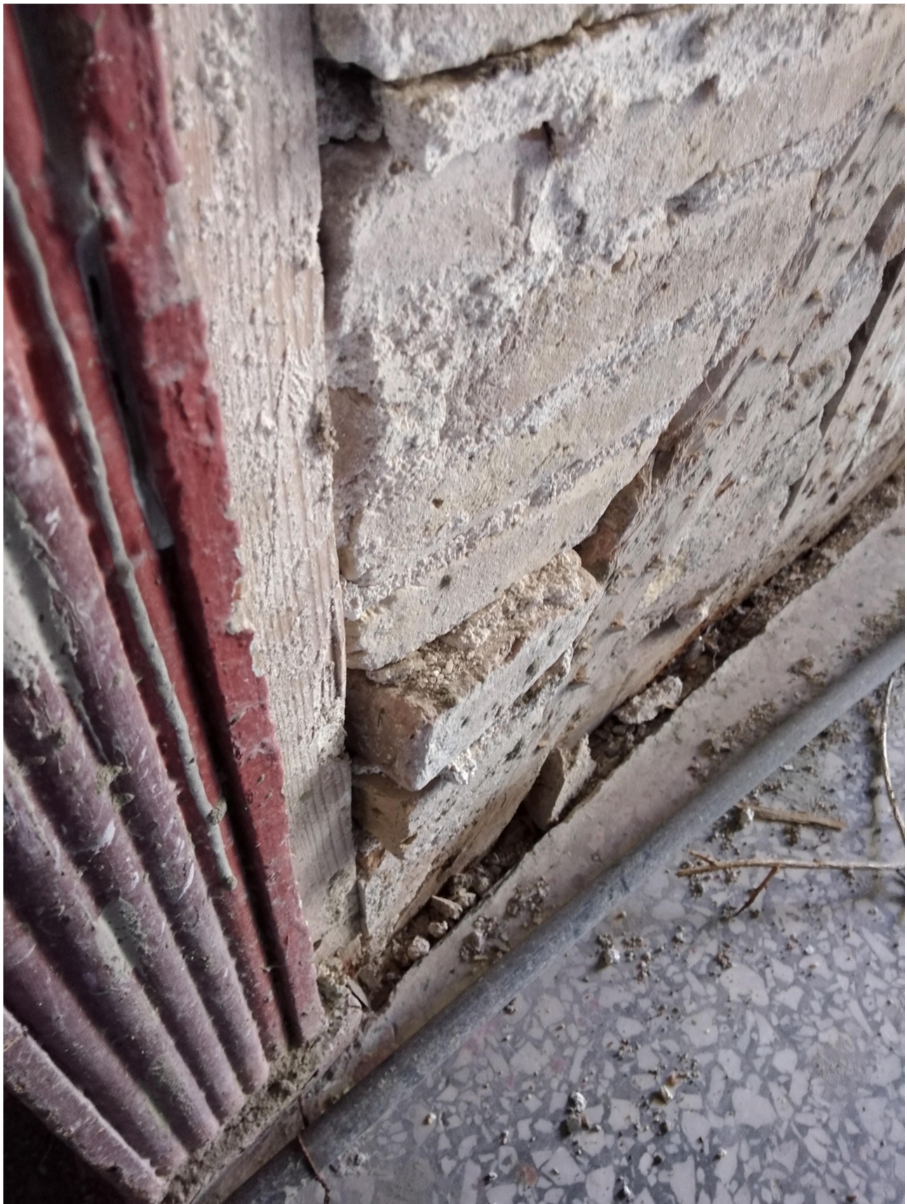
Ζημιές από τις εργασίες απομάκρυνσης των επιχρισμάτων.
