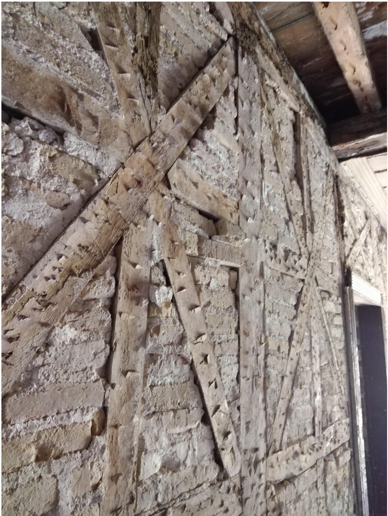
Ακόμα μία περιοχή με εκτεταμένη ζημιά από τις εργασίες απομάκρυνσης των επιχρισμάτων.
